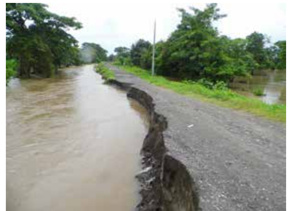
Figura 4. Daños causados en la infraestructura por las inundaciones en Nueva Concepción, Escuintla.
