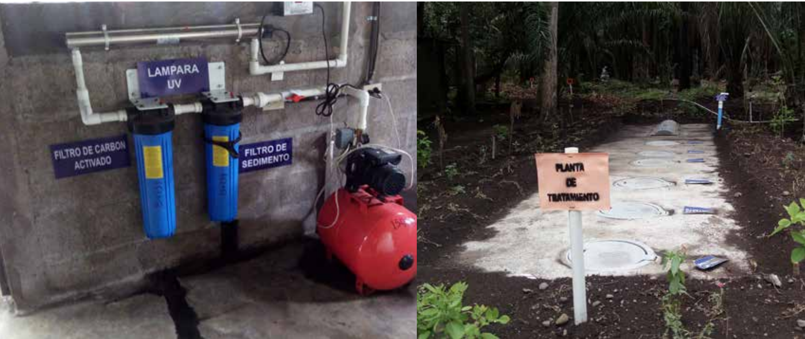
Figura 18. Sistema de potabilización de agua para consumo humano; Sistema de tratamiento de aguas residuales respectivamente, unidad productiva Grupo HAME, cuenca río Madre Vieja
