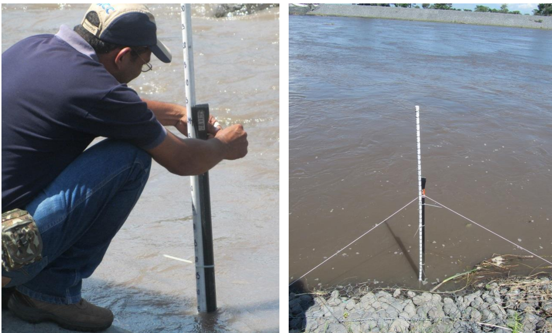
Figura 5. Instalación de equipo para medición de niveles de crecida.
