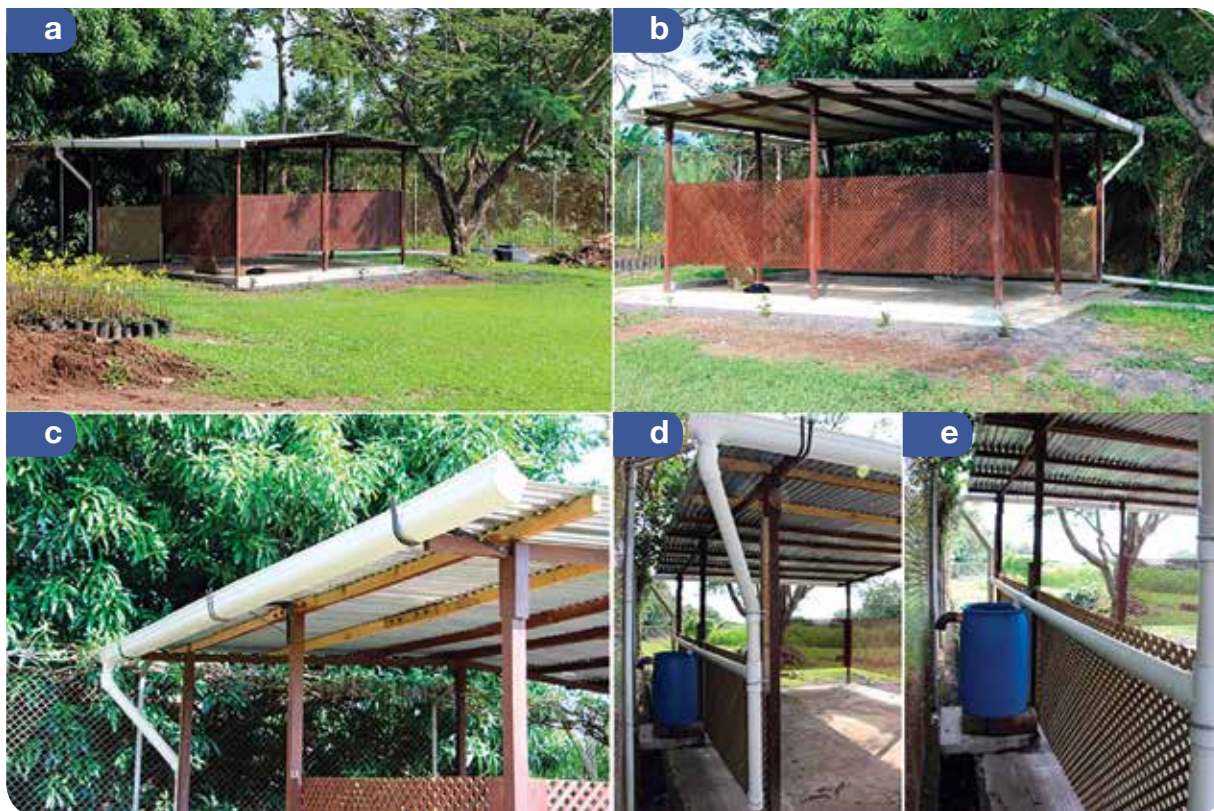
Figura 62. Caseta demostrativa de Sistema de Captación de Agua de Lluvia. a y b) Área de Captación y Conducción, c al e) Detalle del sistema de conducción y filtrado.
