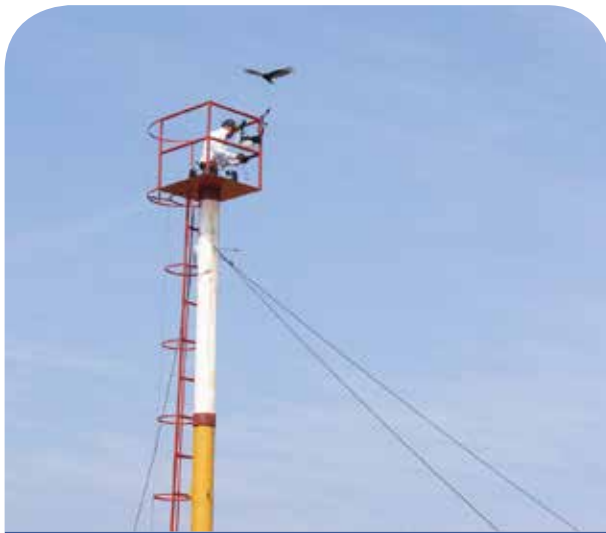
Figura 2. Estación meteorológica Chiquirines. Una estación meteorológica automática como las del ICC, está conformada por tres componentes principales: a) Obra civil, b) Sistema de pararrayos y c) Sensores electrónicos.
