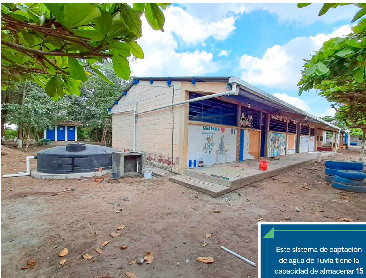
Figura 13. Sistema de captación de agua de lluvia de la Escuela Oficial Rural Mixta (EORM), Nueva Concepción, Escuintla.
